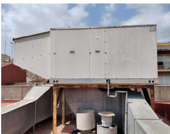
Màquina actual. Roca YORK model: B2IH180A50 E1
