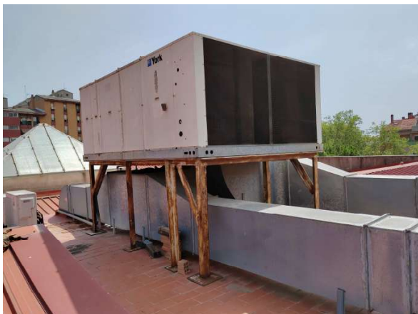
Màquina actual. Roca YORK model: B2IH180A50 E1
