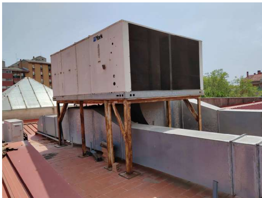
Planta refrigeradora actual. Roca YORK model: B2IH180A50 E1
