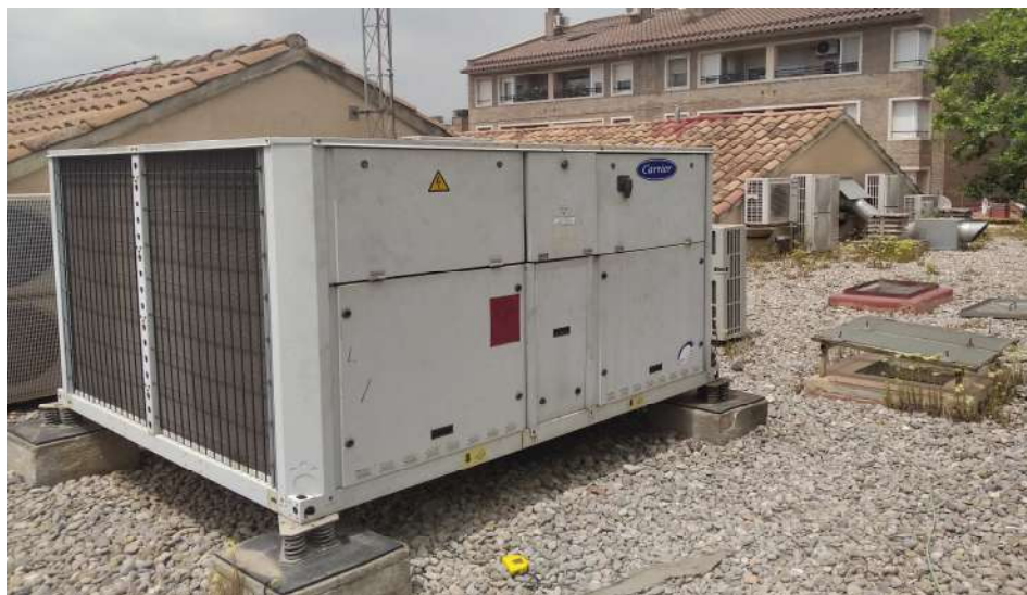
Planta refrigeradora actual. Model CARRIER 30RA-140-0304-EE
