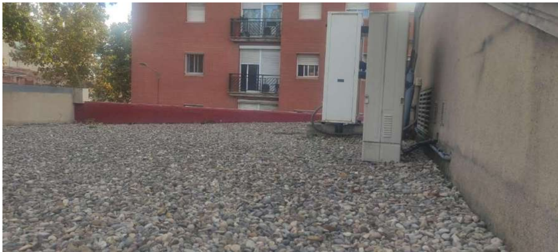
Fig. 24 Ubicació zona inversors i caixa de proteccions CC+CA sobre coberta de grava
